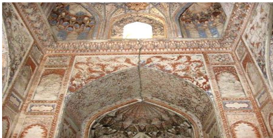
5-расм. Абдулазизхон мадрасаси арка конструкциясида пайдо бўлган ёриқнинг кўриниши
